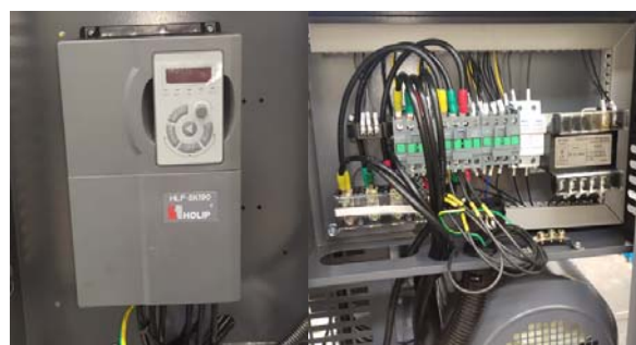
Doble comando redundante: VDF + contactores
