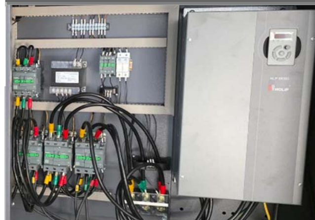
Contactores Schneider Electric Variador de frecuencia Holip
